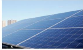
非常用電源 ソーラーパネル充電によるオフィスでの停電対策 建設会社のオフィス
