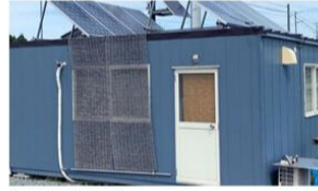
節電対策 ソーラーパネルとの連携による仮設事務所の節電対策 建設現場の仮設事務所
